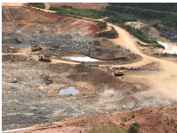
Foto 15: Área de apoio da obra e futura galeria de desvio – limpeza de fundação (05/04/2021)
