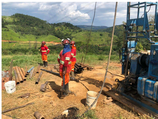
Foto 21: Abertura de poços (PM-BP-09) referente ao Programa de monitoramento das águas subterrâneas (19/03/2021)
